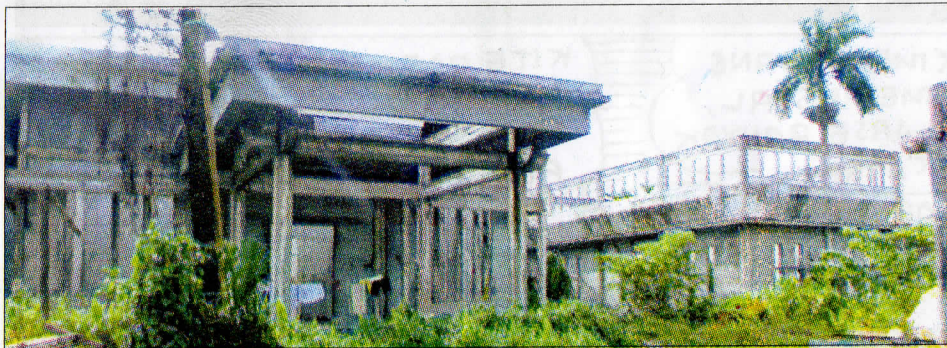
TERBENGKALAI: Rumah Dinas Jabatan Wakil Gubernur Kalbar yang terbengkalai pengerjaannya, malah ditempati warga yang tidak jelas.
