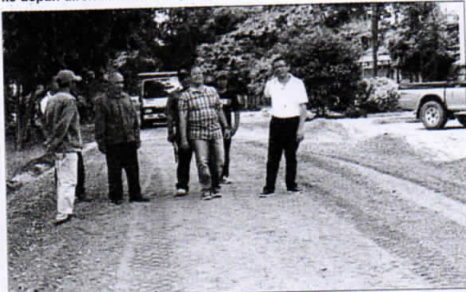
TINGKAT: Wali Kota Sutarmidji meninjau peningkatan Jalan Johan Idrus tahun lalu. Tahun ini (2015), peningkatan jalan tersebut dilanjutkan sampai persimpangan MT Haryono.
