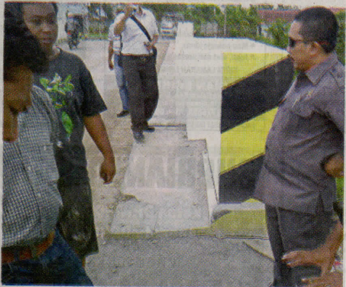
TRIBUN PONTIANAK/RIHARD NELSON MENINJAU - Anggota DPRD Kalbar meninjau Jembatan Parit Jepang di Kubu Raya yang pada bagian oprit mengalami keretakan dan pecah, Kamis (5/1).
