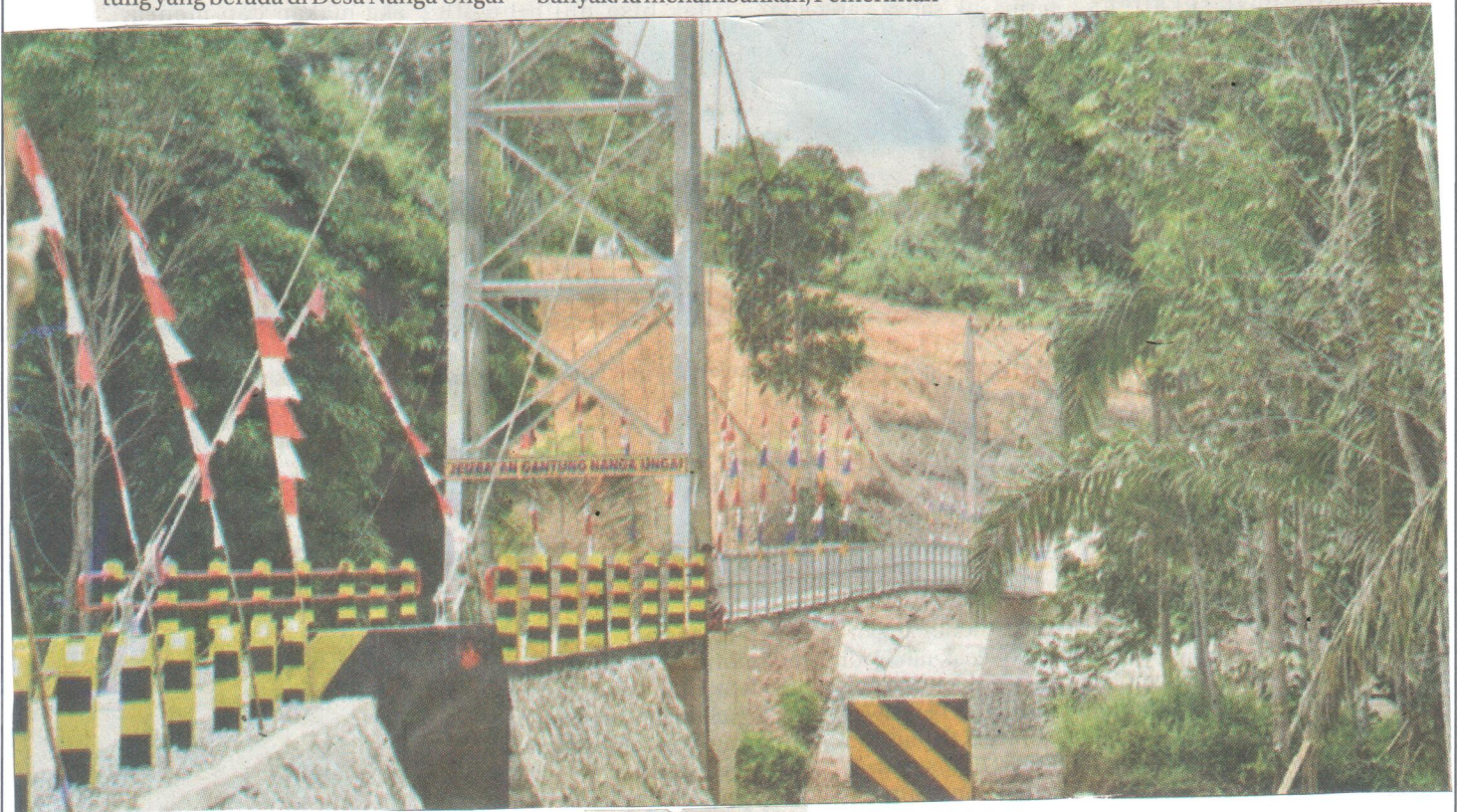
JEMBATAN: Saat ini jembatan gantung rangka baja di Desa Nanga Ungai, Kecamatan Kayan Hulu sudah bisa dinikmati.
