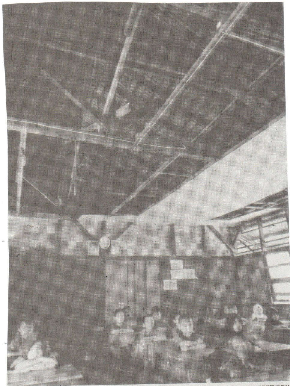
RUSAK – Palfon SD Negeri 5 Twi Mentibar, Kecamatan Selakau, Kabupaten Sambas rusak. Pemkab Sambas diminta meresponsnya.
