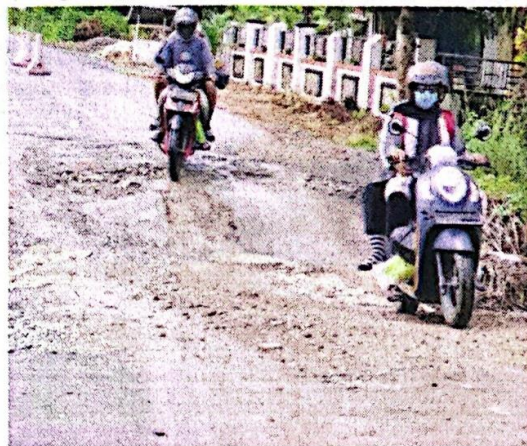
MELINTAS - Pengendara kendaraan melintasi jembatan di jalan provinsi yang ambruk ke bawah di Kecamatan Sukadana, Kabupaten Kayong Utara.
